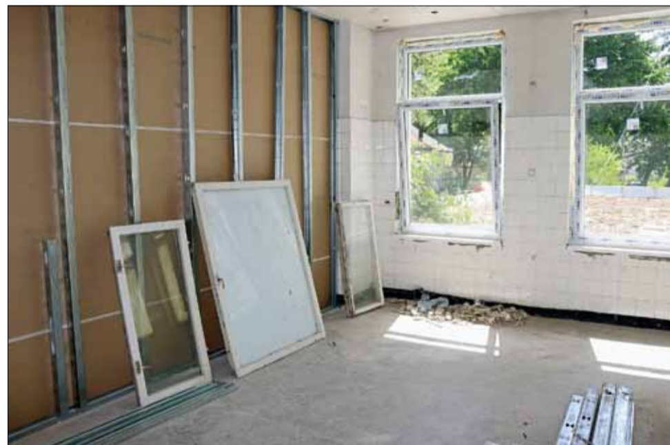
Ремонтът на първия етаж на сградата на бившата болница в града и превръщането му в Център за настаняване от семеен тип на стари хора вече започна.
