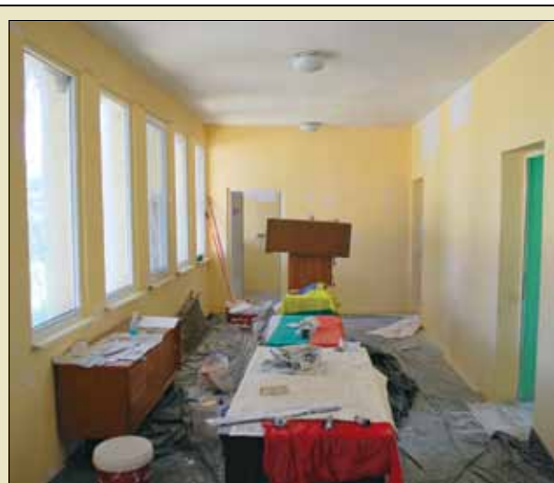
Тече ремонт в сградата на кметство Пчеларово в изпълнение на капиталова програма 21. Строителните дейности предвиждат ремонт на мазилката по фасадата, шпакловане, боядисване и полагане на ламинат във вътрешните помещения.
