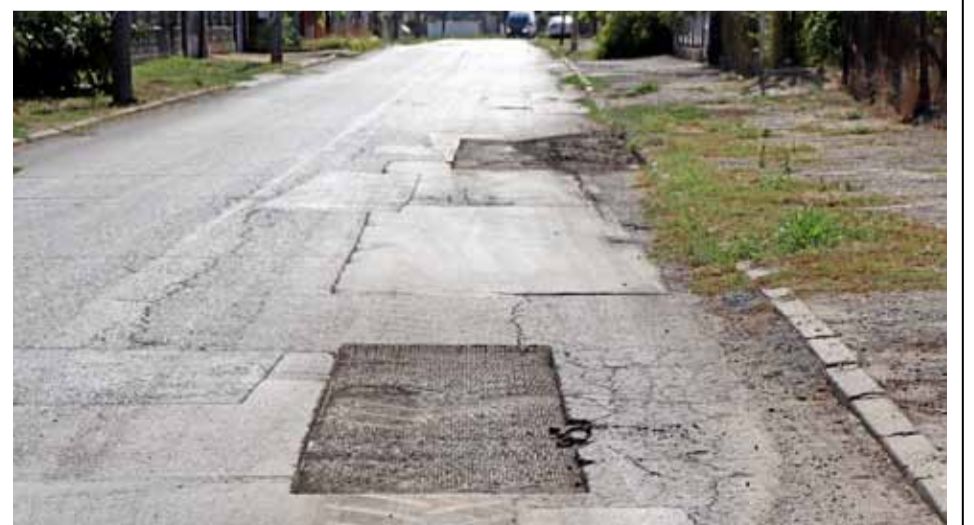
През последните десетина дни в град Генерал Тошево се извършват дейности по изкърпването на улици. Ремонтните работи са по улиците: „Димитър Благоев“, „Васил Априлов“, „Патриарх Евтимий“, „Опълченска“, „Георги С. Раковски“ и „Ал. Стамболийски“. Общата дължина на изкърпените участъци е около 470 м 2 . Дейностите ще продължат с цялостно преасфалтиране на две улици в град Генерал Тошево – „Марица“ (с дължина от 180 м.) и „Струма“ (с дължина от 100 м.).
